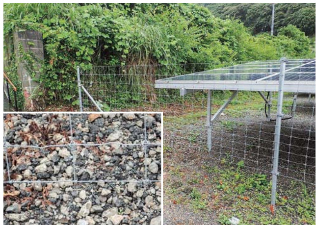
写真3 太陽光発電施設（左後方の草や壁で多数確認）とアスファルト舗装の細片が混じる埋め戻し材
